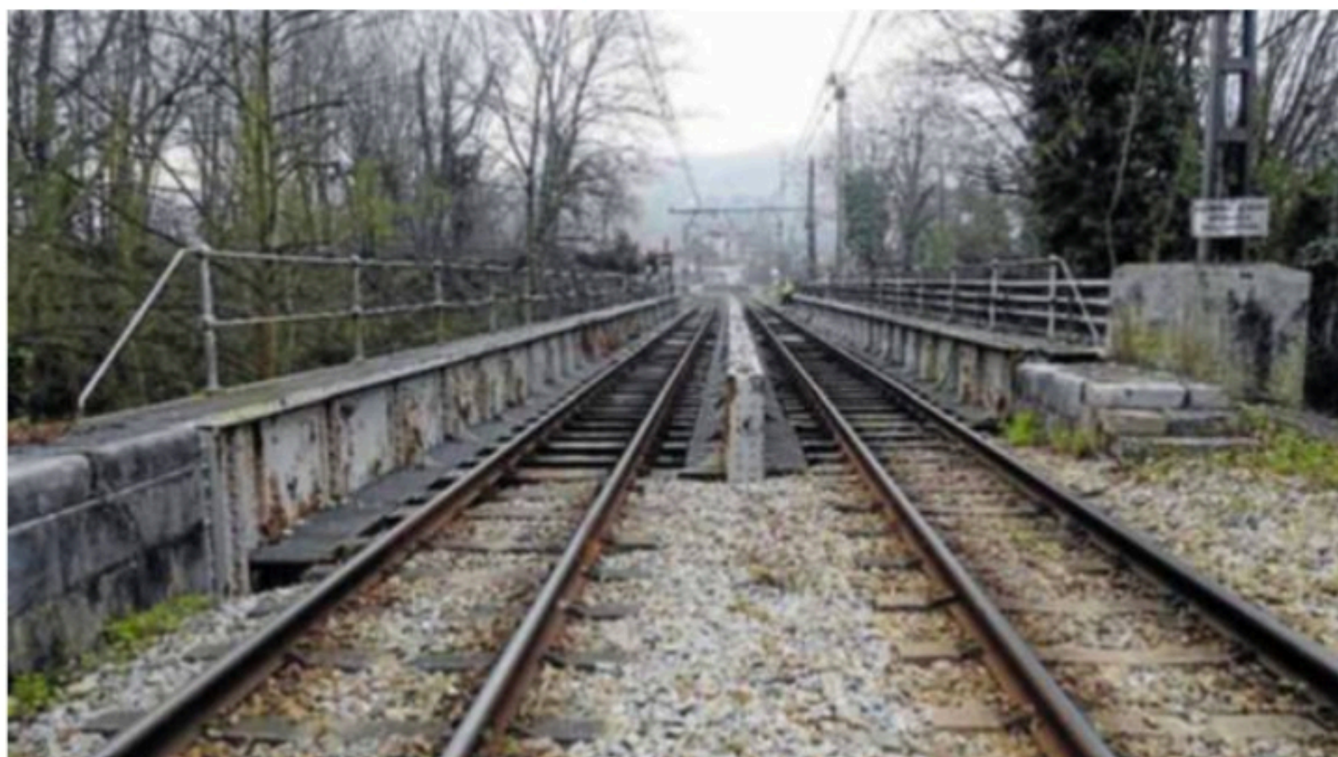
Puente metálico con dos vías que Adif procederá a sanear en una obra inicialmente prevista para durar once meses de trabajo efectivo. ADIF
