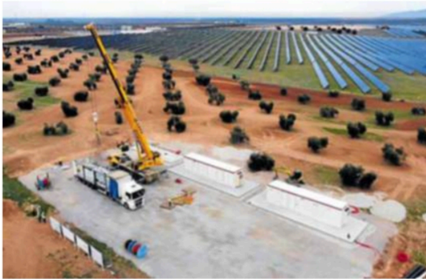
Parque de baterías recicladas de vehículos eléctricos que Eiffage instala en una planta fotovoltaica de Extremadura. EIFFAGE ENERGÍA SISTEMAS
